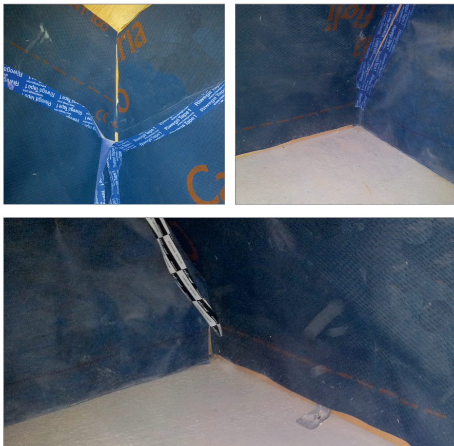
Figura 3.12. Esempi di errata posa in opera di membrane e teli.
